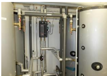
Akumulační zásobníky v technické místnosti bytového domu – vpravo: zásobníky NADO 500/25 v6, vlevo: NADO 750/35 v6, vpředu: solární čerpadlová skupina solárního systému Suntime (foto: PROPULS SOLAR s.r.o. a DZD)
