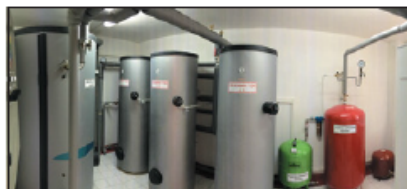
▲ Obr. ● Strojovna panelového domu v Turně nad Bodvou s tepelným čerpadlem země-voda NIBE F1345
