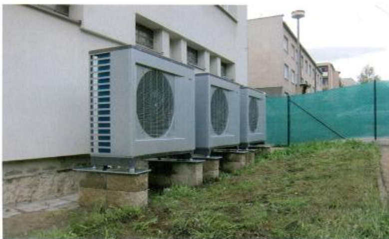
Kaskádové propojení tří tepelných čerpadel systému vzduch-voda NIBE F2300 (vedle panelového domu v Dobrovici)
