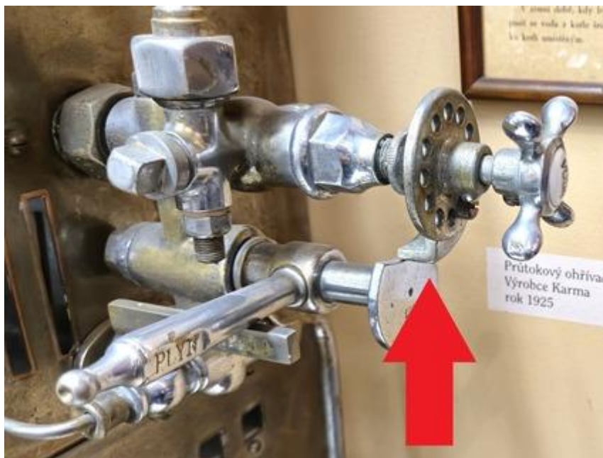
Obr. 4 Jedno z mechanických řešení blokace plynového kohoutu zabráňujícího destrukci ohřivače. Pákou otevírající plynový ventil nebylo možné pohnout, dokud nebyla odblokována pootočením, tedy otevřením ventilu průtoku vody. Uzavření průtoku vody muselo předcházet uzavření přívodu plynu. (Foto a copy: autor. Plynárenské muzeum, Pražská plynárenská a.s.)
