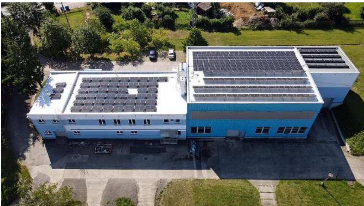
Fotovoltaická elektrárna na střeše úpravny vody v Dobřanech
