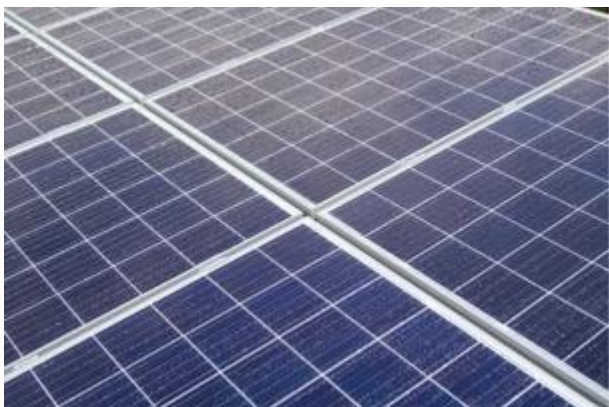
Malá fotovoltaická elektrárna zajistí také úsporu za ohřev TUV a navíc má i další benefity – sníží ostatní spotřebu domu na vytápění, větrání či další technologie. Foto: V-System
