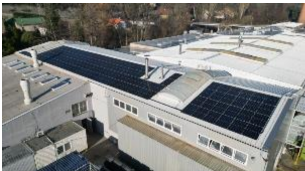
Fotovoltaická elektrárna v Dražicích
