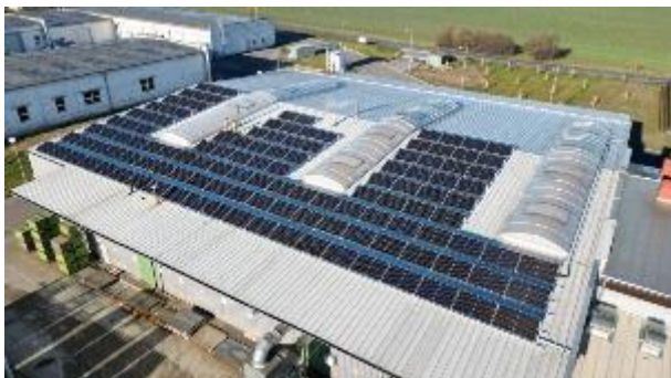
Fotovoltaická elektrárna v Luštěnicích
