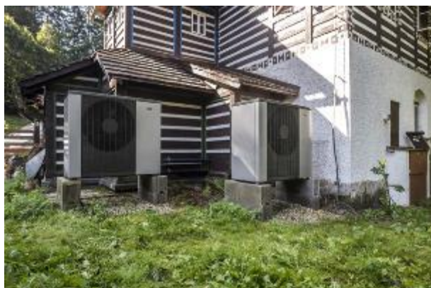
Kaskáda dvou tepelných čerpadel vzduch-voda NIBE F2120-20 s provozní teplotou až do -25 °C s výstupní teplotou až 65 °. Foto: DZ Dražice
