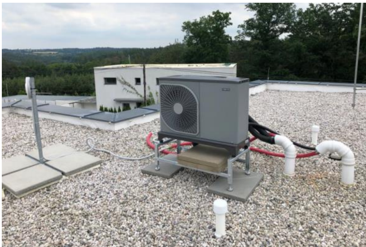
Venkovní jednotka tepelného čerpadla NIBE F2040-6 na střeše rodinného domu v...
